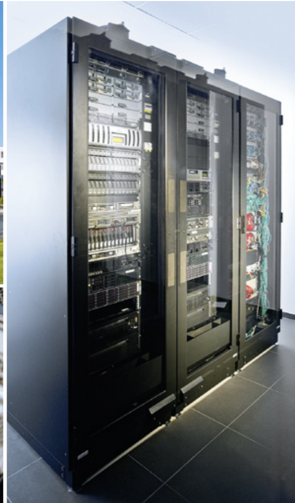
Gelebte Virtualisierung: Ein modernes Rechenzentrum im Bechtle IT-Systemhaus München.
